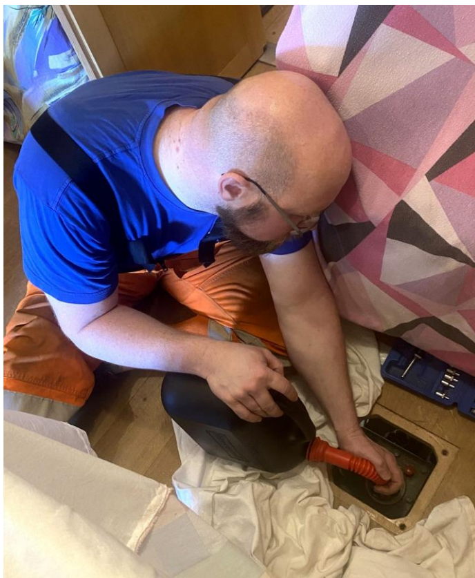
Bild 7 Marco befüllt den Ölbehälter des Kompressors
